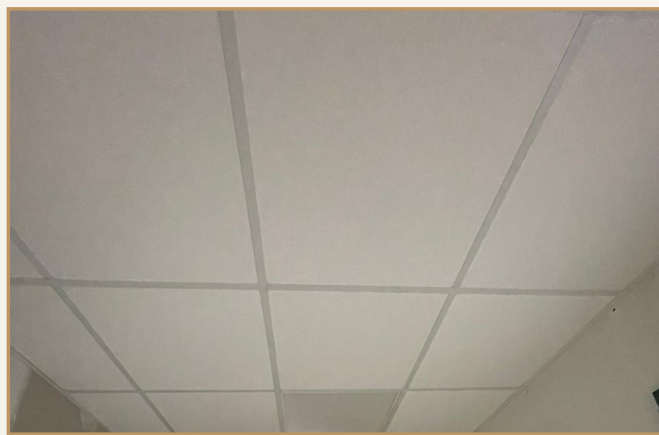
Controsoffitto a pannelli modulari
